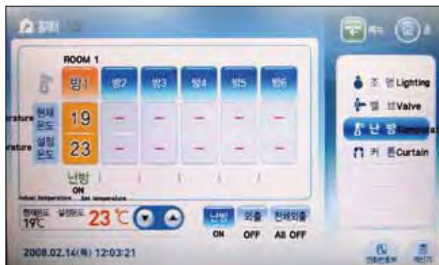
Komfortable Bedienung der KNX Funktionen über zentrales Touch-Panel: Zum Beispiel Menü für Heizung, Vorhänge und Beleuchtung.
